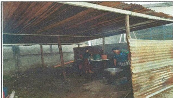
Foto 1: Paredes de lámina y piso de tierra. Se mejorarán las paredes con block y cernido y piso cerámico.
